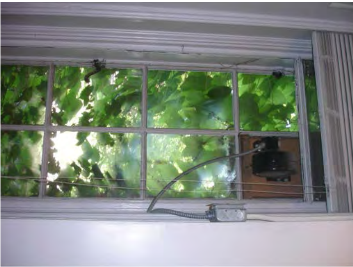
Toilet room exhaust fan
