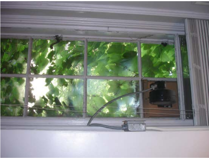
Toilet room exhaust fan
